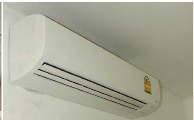
ภาพที่ 2-4 เครื่องเป่าลมเย็น (Fan Coil Unit) หลังปรับเปลี่ยน
