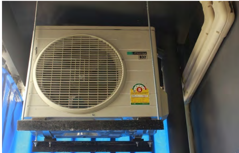
ภาพที่ 2-2 เครื่องควบแน่น (Condensing Unit) หลังปรับเปลี่ยน
