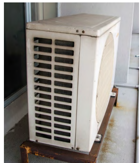
ภาพที่ 2-1 เครื่องควบแน่น (Condensing Unit) ก่อนปรับเปลี่ยน
