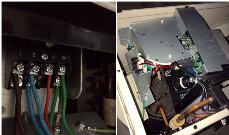
ภาพที่ 2-6 ระบบไฟฟ้าและแผงวงจรควบคุมมอเตอร์คอมเพรสเซอร์ของเครื่องปรับอากาศแบบแยกส่วนระบบอินเวอร์เตอร์
