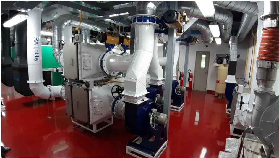
ภาพที่ 5 งานปรับปรุงสิ่งก่อสร้างเพื่อสนับสนุนพันธกิจด้านการวิจัย (ห้องควบคุมระบบปรับอากาศภายในห้องปฏิบัติการชีวโมเลกุลระดับ 3 (BSL3) ชั้น 9 อาคารราชนครินทร์)
